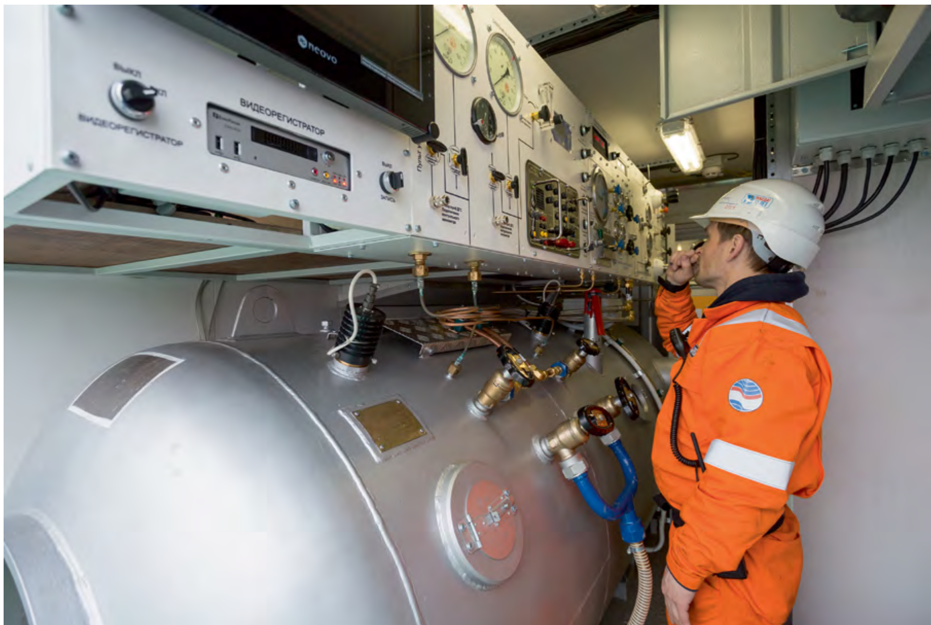
ОБЕСПЕЧЕНИЕ РАБОТЫ БАРОКАМЕРЫ МФАСС «Балтика»
